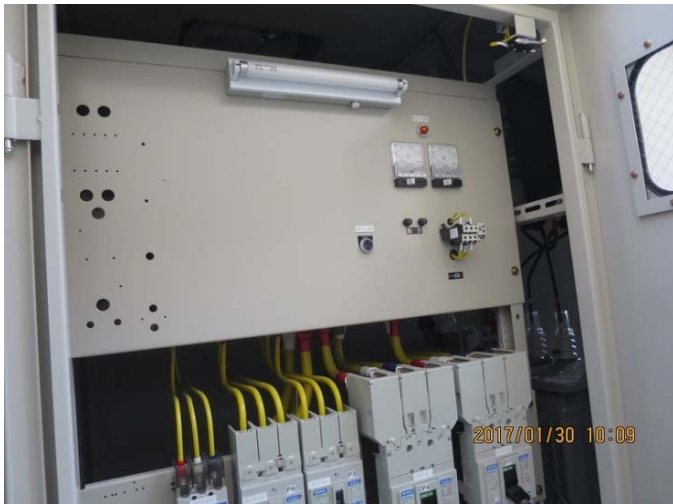
<動力配電盤 - 前面パネル>
